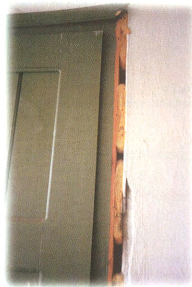
Εικ.24 Κακή κατάσταση κουφώματος-χαραμάδες
