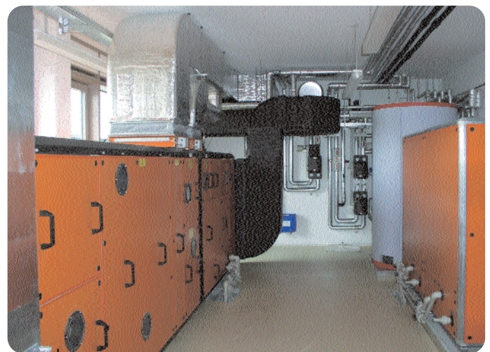
Φωτογραφία 7 Σύστημα ψύξης υγρού μέσου DEC εγκατεστημένο στο νέο κτίριο του "Solar Building Innovation Center (SOBIC)" στο Freiburg (D)
