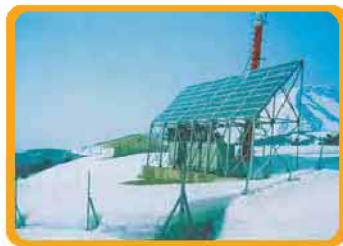
Σχήμα 7. Αυτόνομο φωτοβολταϊκό σύστημα τηλεπικοινωνιών στο όρος Δίφφη
