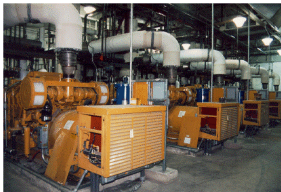
Σχήμα 16. Οι ηλεκτρογεννήτριες με τη μονάδα ανάκτησης θερμότητας
