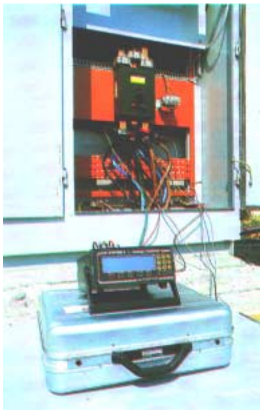
Σχήμα 3.1. Αναλυτής ηλεκτρικής ισχύος
