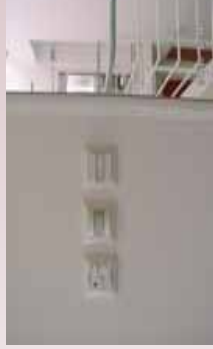
φωτό 2. Αισθητήρες και σημεία ελέγχου συστημάτων BEMS
