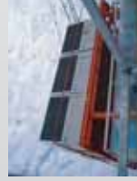
Φωτό 5. Άποψη των μονάδων αεριοψυκτών συνολικής ισχύος 560 kW
