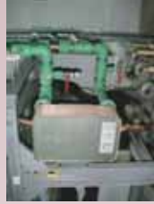
Φωτό 11. Ο αεριεπιθέρμαντης ανάκτησης θερμότητας πάνω στον υδρόψυκτο ψύκτη
