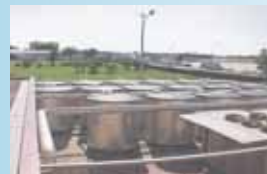
Φωτο 1. Αποθήκευση ψύξης σε κτίριο. Το επερχόμενο τριζωνικό τιμολόγιο θα αναδείξει ακόμα περισσότερο τα συστήματα αυτά
