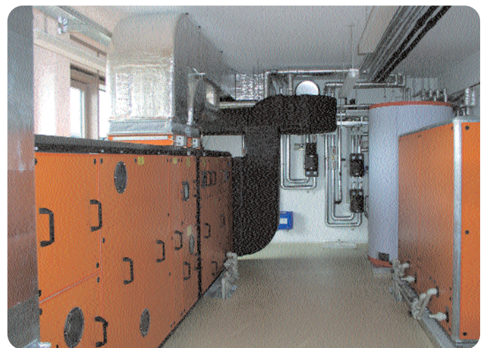
Φωτογραφία 7 Σύστημα ψύξης υγρού μέσου DEC εγκατεστημένο στο νέο κτίριο του "Solar Building Innovation Center (SOBIC)" στο Freiburg (D)
