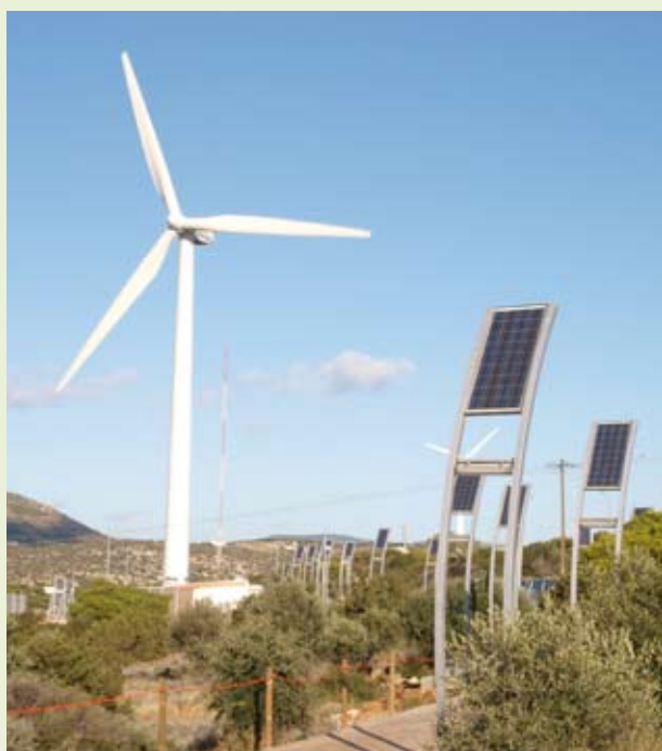
Σύστημα υπαίθριου φωτισμού με αυτόνομα φωτοβολταϊκά φωτιστικά - ΠΕΝΑ
