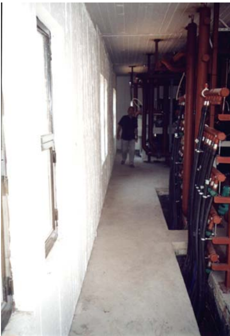
Εικόνα 15: Κτίριο Μεταλλειολόγων, συλλέκτες νερού από-προς τους εναλλάκτες εδάφους, πίσω όψη.
