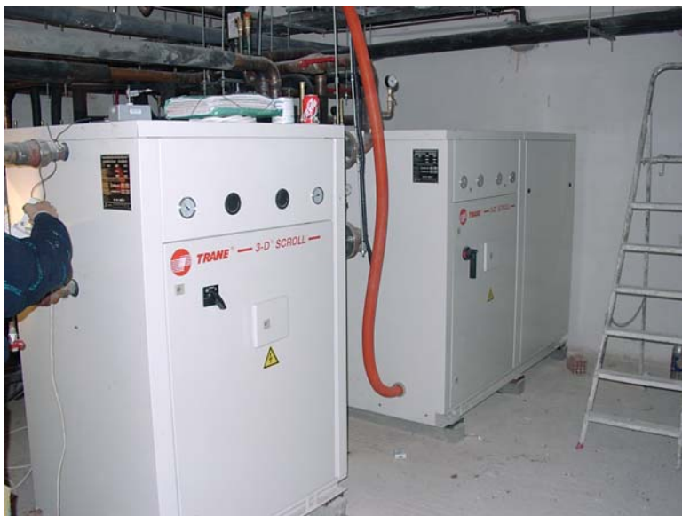
Εικόνα 8: Ευρωπαϊκό Κέντρο Δημοσίου Δικαίου, υδρόψυκτες αντλίες θερμότητας.
