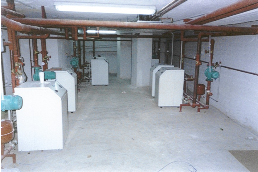
Εικόνα 6: Μηχανοστάσιο του Δημαρχείου Πυλαίας με γεωθερμικές αντλίες θερμότητας.
