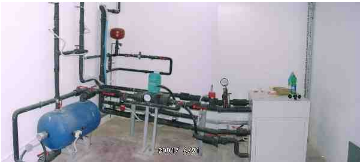
Εικόνα 11: Γραφεία ΚΑΠΕ, μηχανοστάσιο με την αντλία θερμότητας και τον συνοδευτικό μηχανολογικό εξοπλισμό
