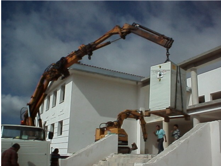
Εικόνα 7: Ευρωπαϊκό Κέντρο Δημοσίου Δικαίου, άποψη του κτιρίου κατά τη διάρκεια των έργων.
