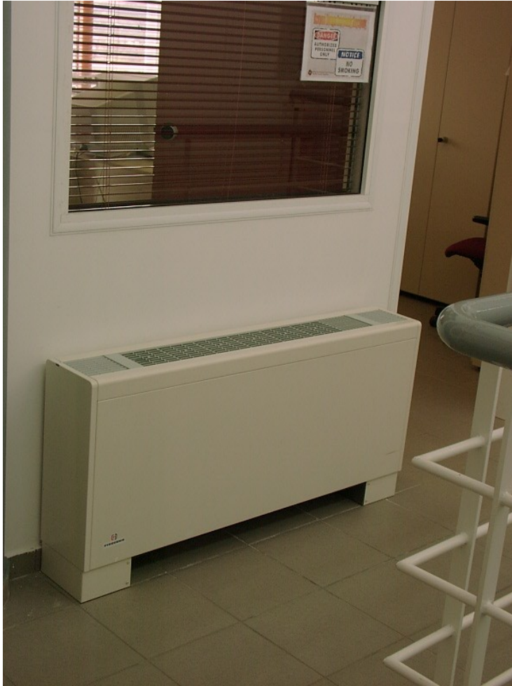
Εικόνα 12: Γραφεία ΚΑΠΕ, αερόθερμο δαπέδου τροφοδοτούμενο από τη γεωθερμική αντλία θερμότητας.
