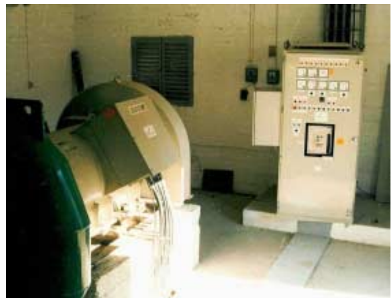
Εσωτερικό Μηχανοστασίου ΜΥΗΕ Αγκίστρο Ι Σερρών. Ισχύς 0.5 MW. Κύριος του έργου 'Κοινοτική Επιχείρηση Αγκίστρο «Μέγας Αλέξανδρος»'. Έτος κατασκευής 1994
