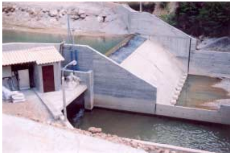
Υδροληψία ΥΗΕ Τσιβλού. Ισχύς 2.7 MW). Κύριος του έργου 'Αμιγής Δημοτική Επιχείρηση «Υδροηλεκτρικός Σταθμός Τσιβλού»' της τότε Κοινότητας Πλατάνου Αχαΐας. Έτος ολοκλήρωσης 1999
