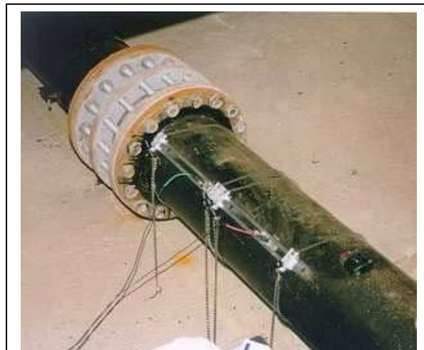
Αισθητήρια μέτρησης παροχής αγωγού προσαναωής με σύστημα υπερήχων
