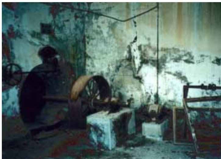
Εσωτερικό Μηχανοστασίου ΜΥΗΕ Κοπανίτσας, Λακωνία
