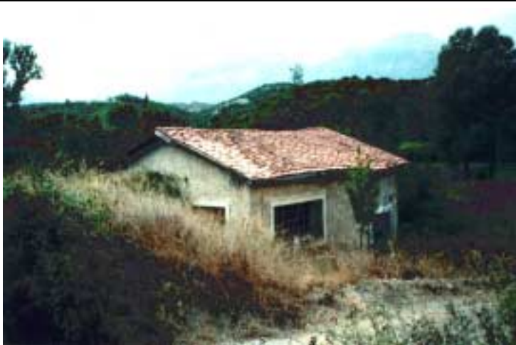
Μηχανοστάσιο μη λειτουργούντος ΜΥΗΕ Κοπανίτσας κατασκευής 1950, Πηγές Βιβάρι Λακωνίας
