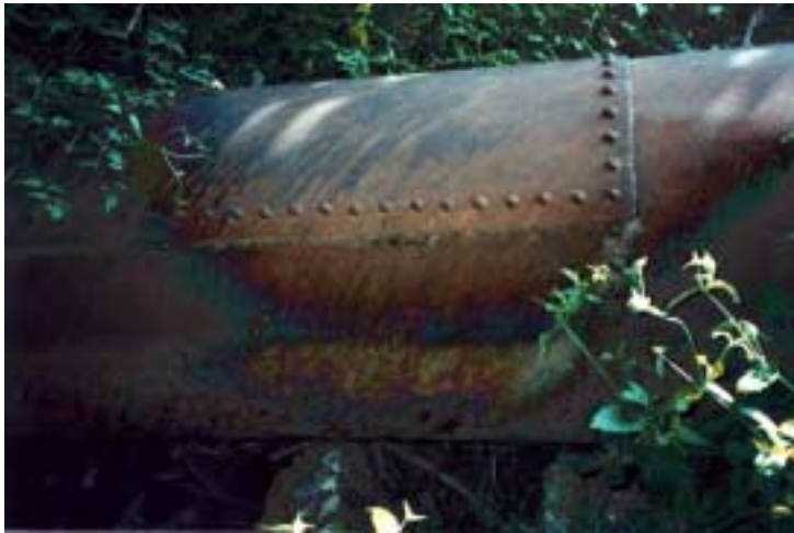
Καταθλιπτικός αγωγός με ήλους κατασκευής 1930 μη λειτουργούντος ΜΥΗΕ εταιρείας ΣΕΦΕΚΟ, Έδεσσα
