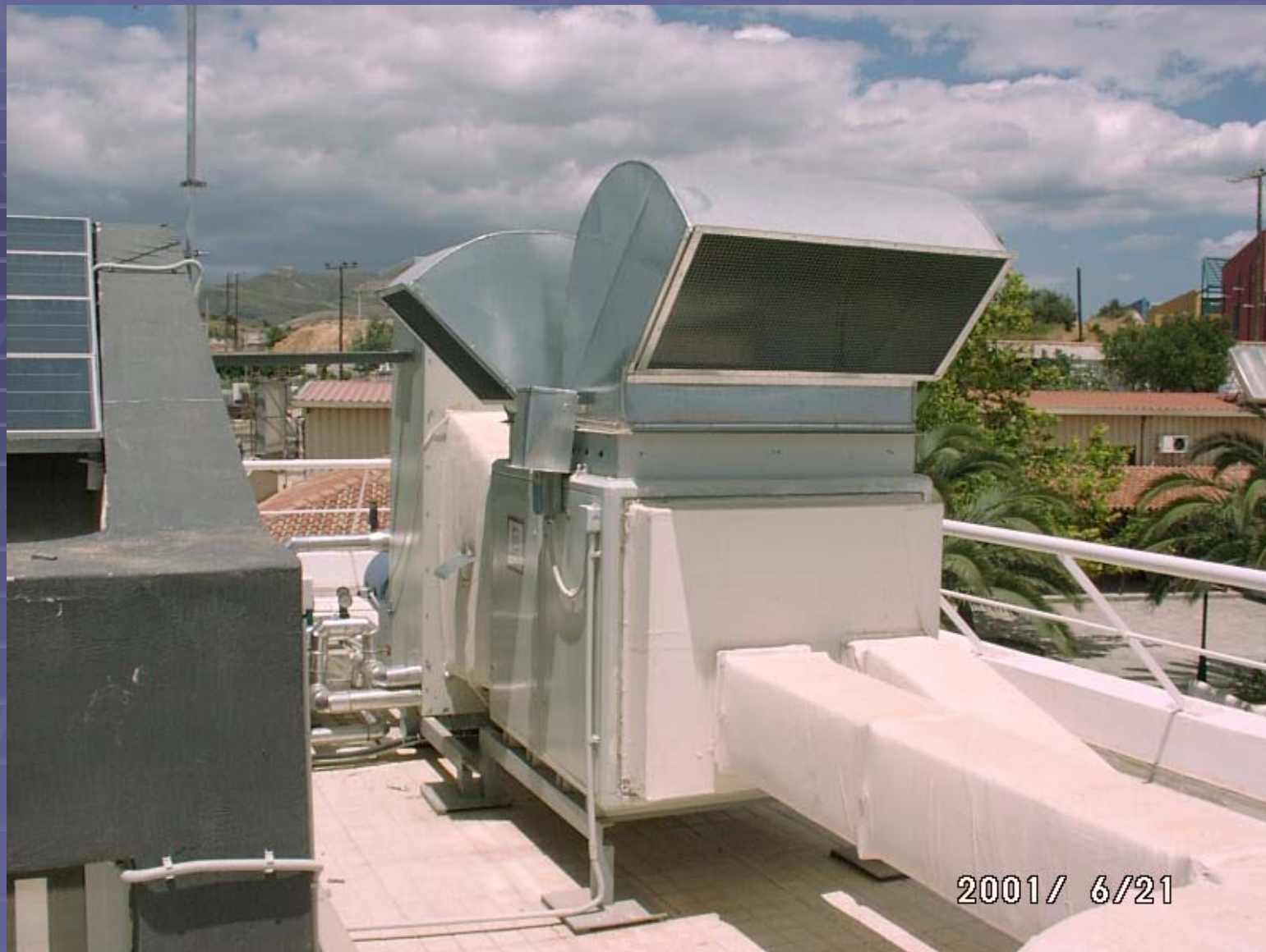
ΑΝΤΛΙΑ ΘΕΡΜΟΤΗΤΑΣ ΤΥΠΟΥ Α - Ν ΙΣΧΥΟΣ 18KW ΓΙΑ ΤΟΝ ΚΛΙΜΑΤΙΣΜΟ ΤΟΥ ΟΡΟΦΟΥ. (ΤΟΝ ΧΕΙΜΩΝΑ ΥΠΑΡΧΕΙ Η ΔΥΝΑΤΟΤΗΤΑ ΤΡΟΦΟΔΟΣΙΑΣ ΤΗΣ ΜΕ ΠΡΟΘΕΡΜΑΣΜΕΝΟ ΑΕΡΑ ΑΠΟ ΤΟΥΣ ΑΕΡΟΣΥΛΛΕΚΤΕΣ)
