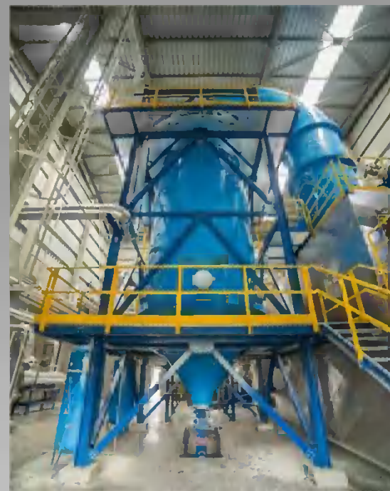
Λεβητοστάσιο διαθερμικού ελαίου
