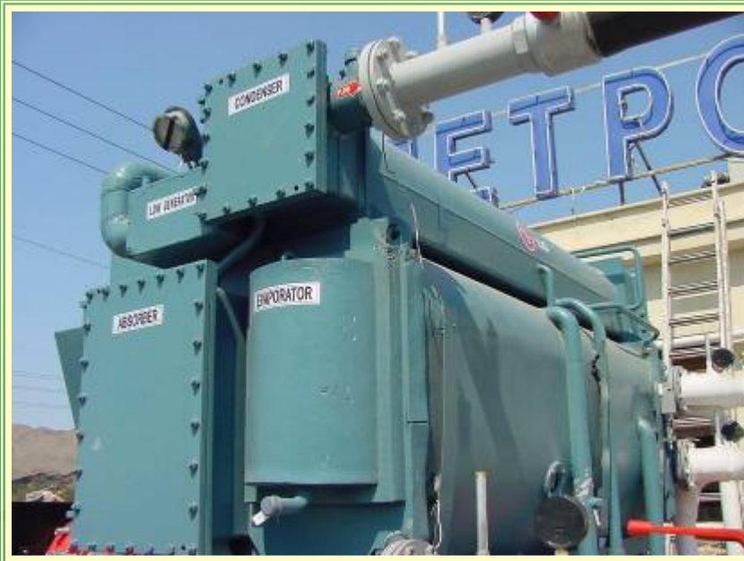
Κλιματισμός γραφείων-ΠΕΤΡΟΓΚΑΖ Α.Ε.
