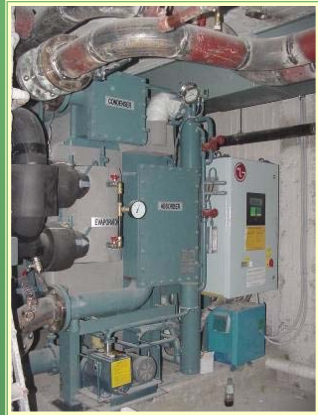
Κλιματισμός ξενοδοχείου CENTRAL
