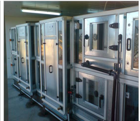
Ηλιακός Κλιματισμός με Στερεό DEC στο Πάρκο Ενεργειακής Αγωγής του ΚΑΠΕ. Φωτό: Αρχείο ΚΑΠΕ.
