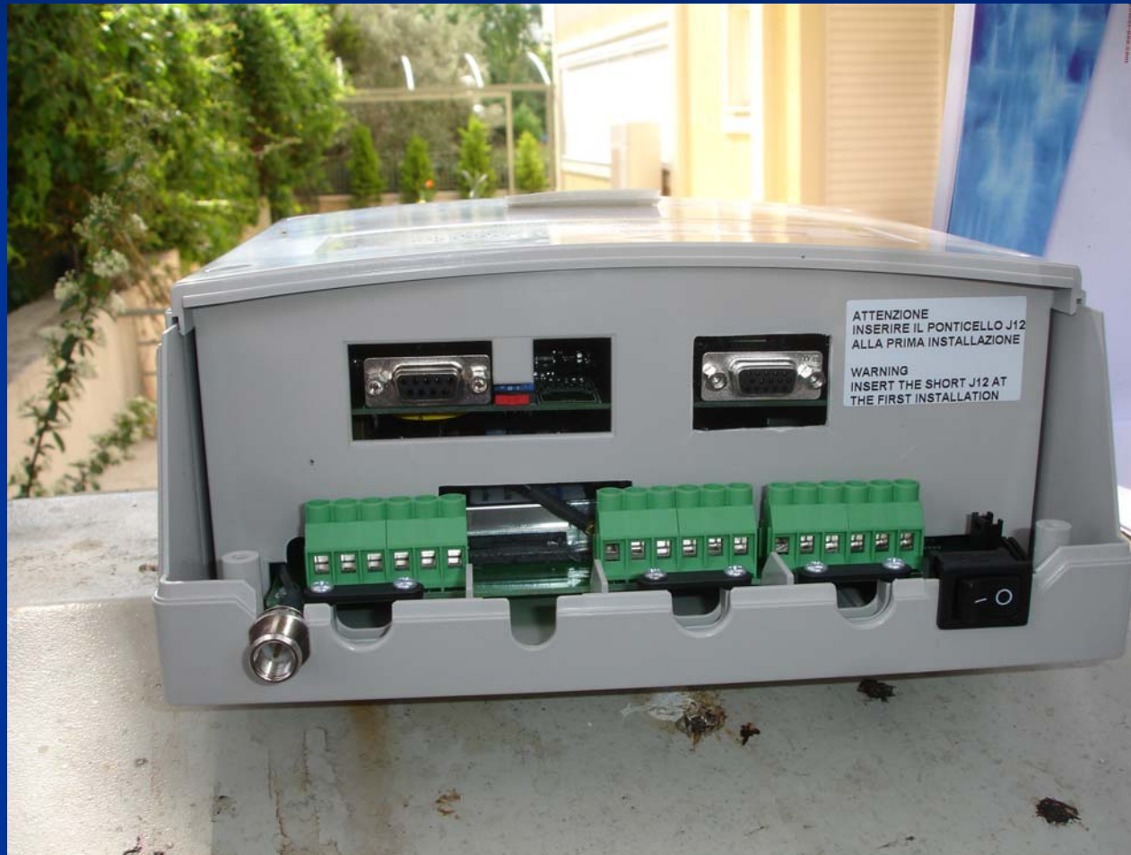
Κεντρική Μονάδα Διαχείρισης Πίλαρ Δικτύου Οδοφωτισμού
