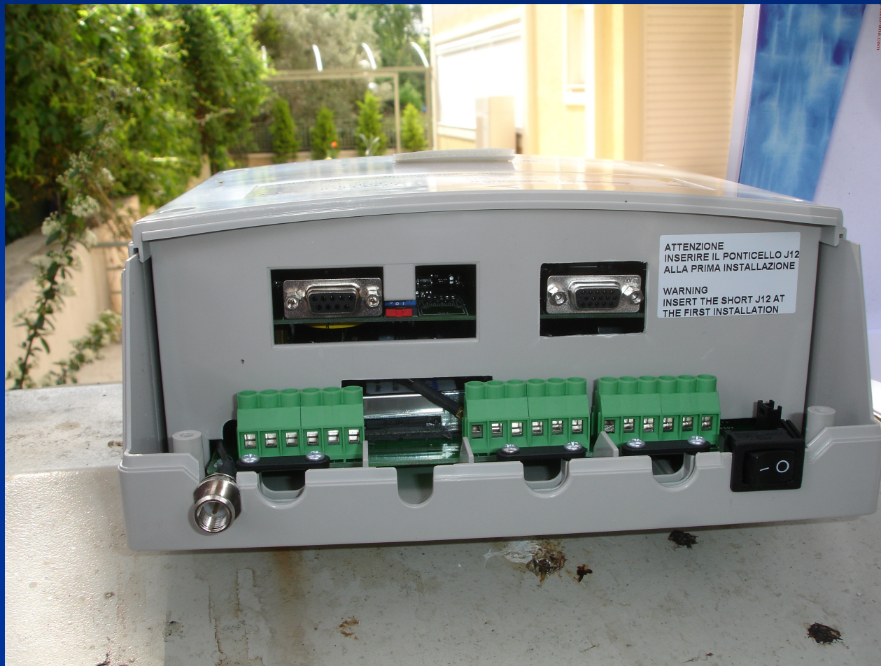
Κεντρική Μονάδα Διαχείρισης Πίλαρ Δικτύου Οδοφωτισμού
