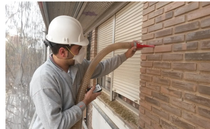
Θερμομόνωση στο διάκενο τοιχοποιίας - Βαλένθια
