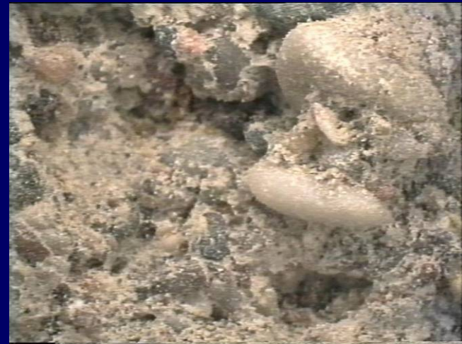
Επιφάνεια σκυροδέματος x25 του κτιρίου Ροτόντας
