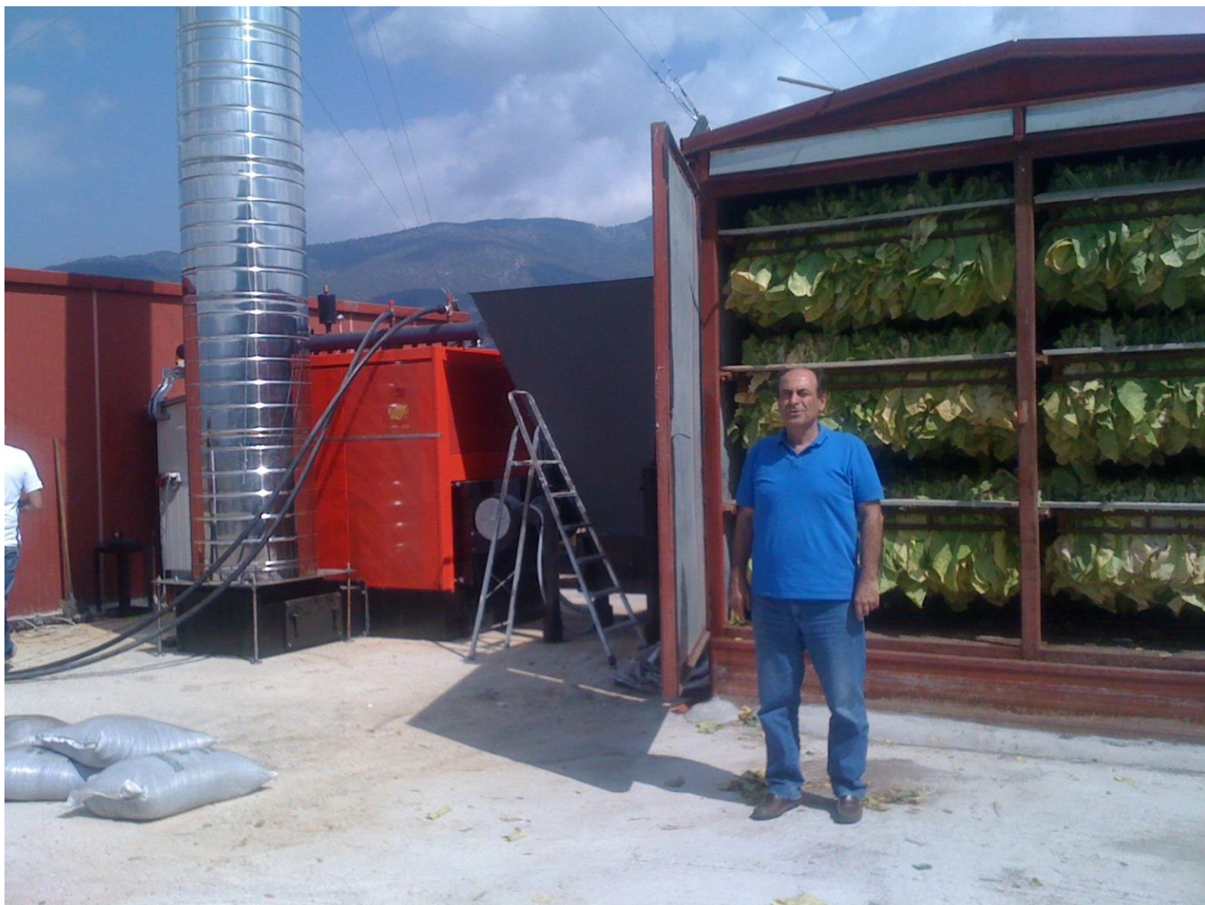
Πυρηνολέβητας σε Ξηραντήριο φύλλων Καπνού.
