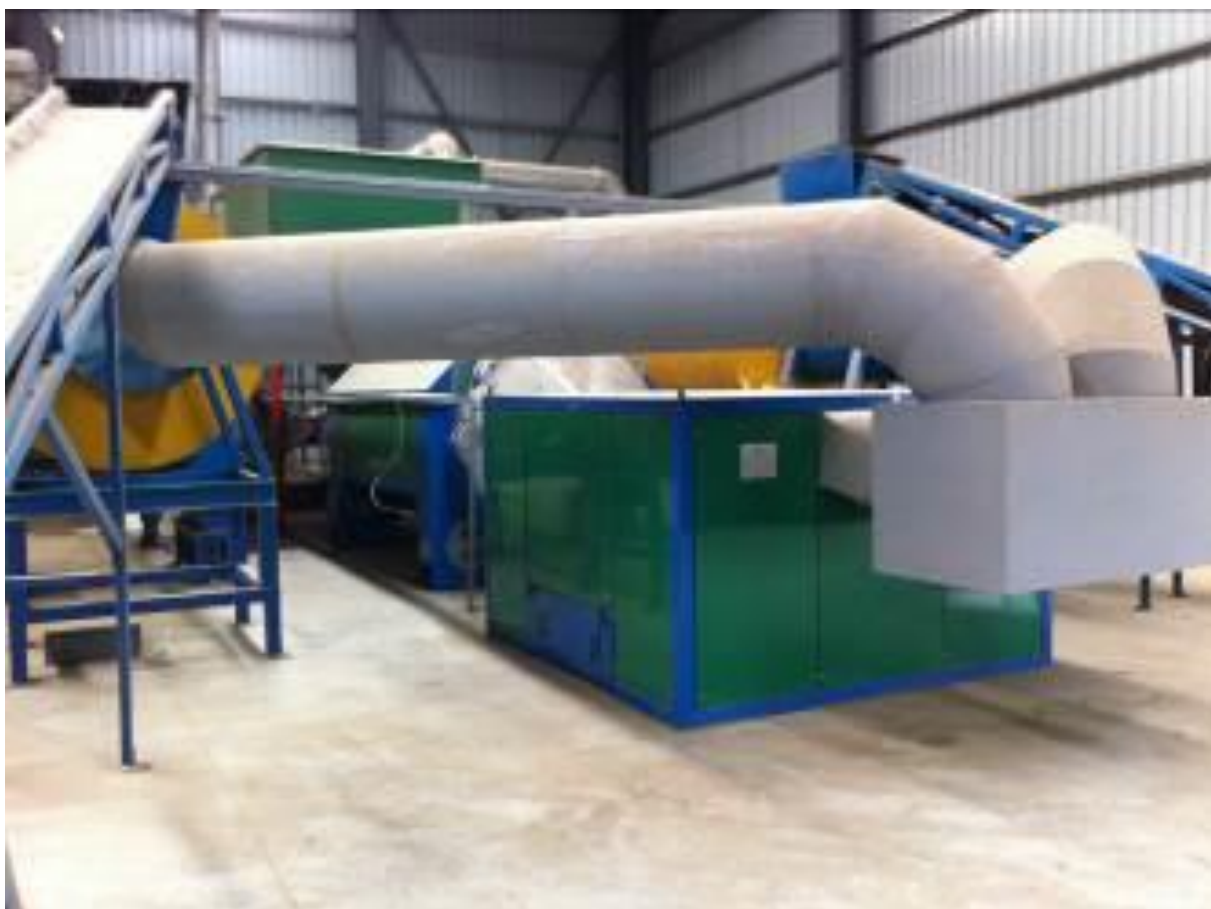
Καυστήρας 2 Gcal/h σε δύο περιστροφικά ξηραντήρια.
