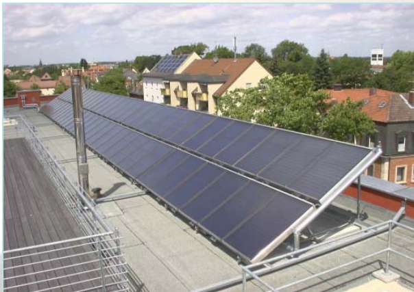
Νυρεμβέργη, Pegnitzlofts: 80m 2 Ζεστό νερό και θέρμανση χώρων.
