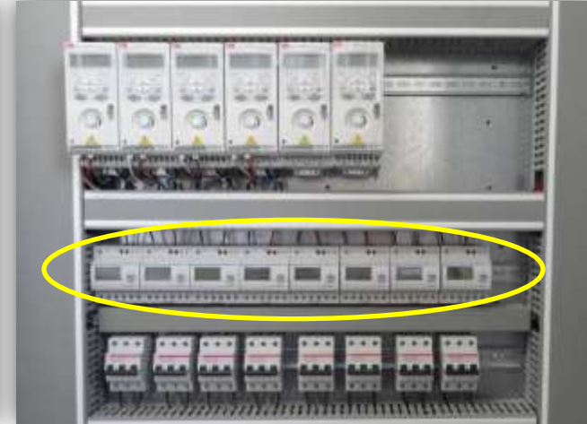
8 Μετρητές ηλεκτρικής ενέργειας
