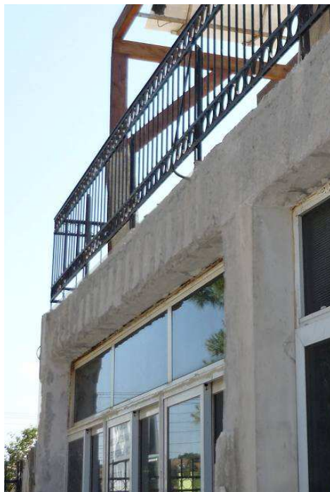
Αμόνωτο δοκάρι μετά από απομάκρυνση επιχρίσματος
