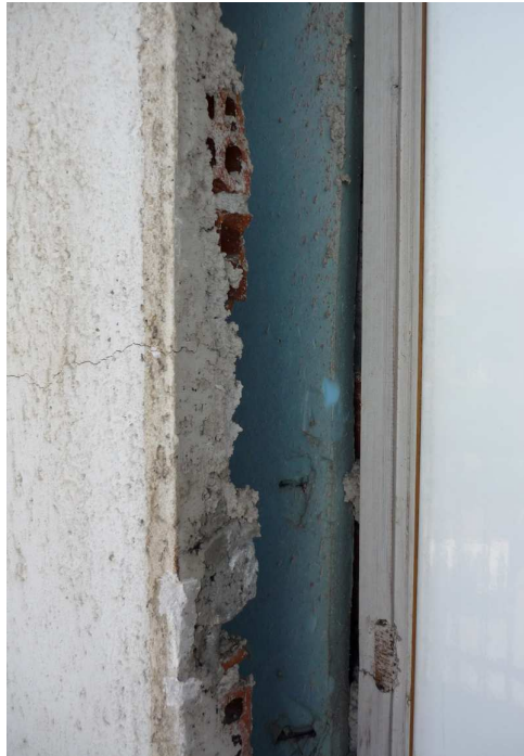
Μόνωση στο κενό διπλής τοιχοποιίας
