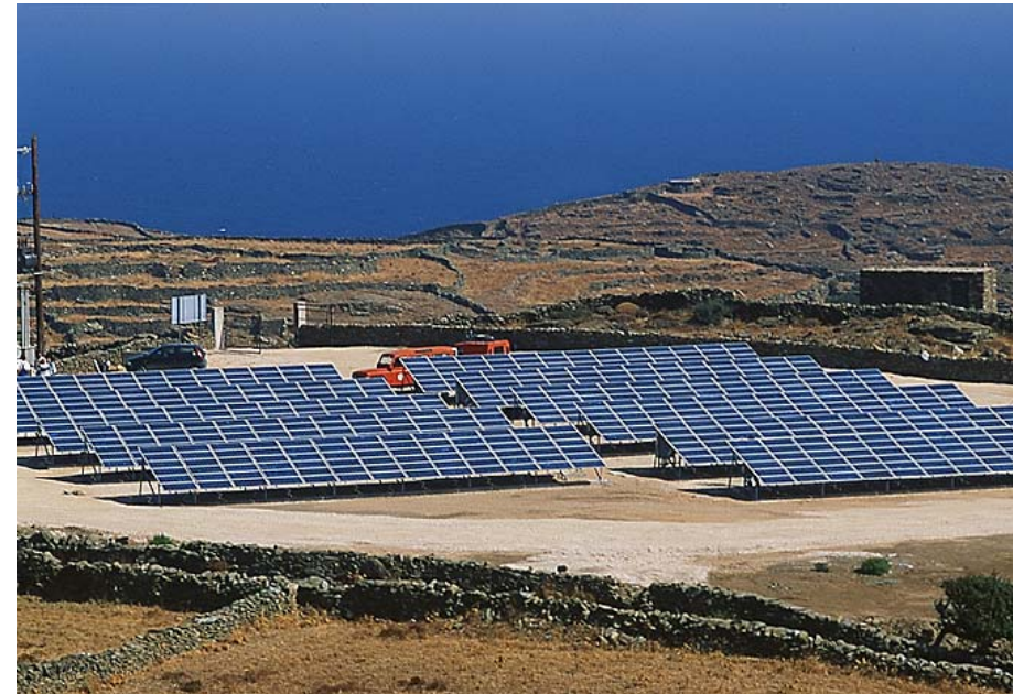
Φ/Β σύστημα 60kWp στη Σίφνο (1999) 7
