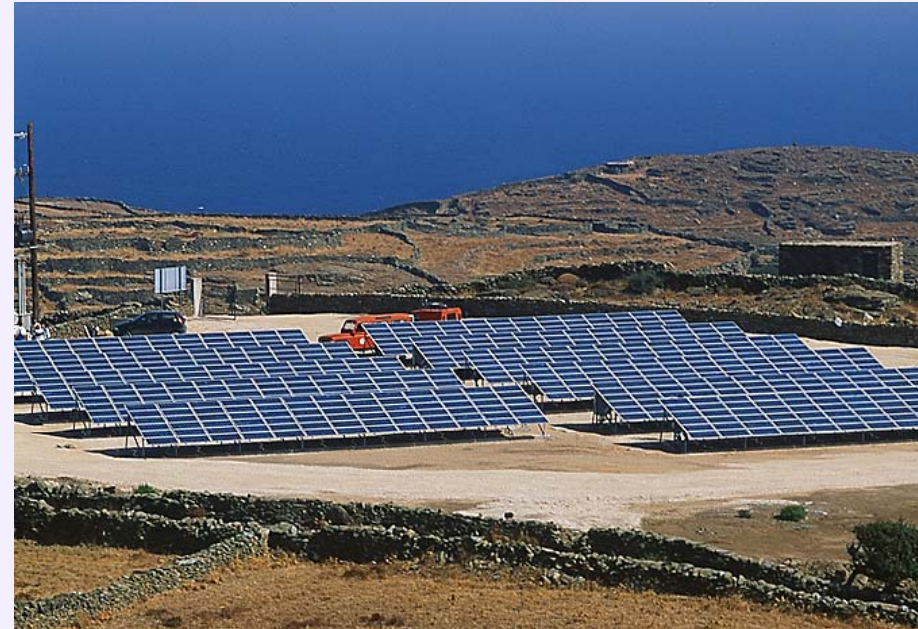
Φ/Β σύστημα 60kWp στη Σίφνο (1999)
