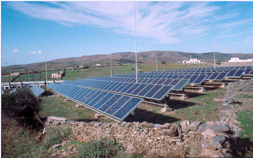
Φ/Β σύστημα 100kWp στην Κύθνο (1983)
