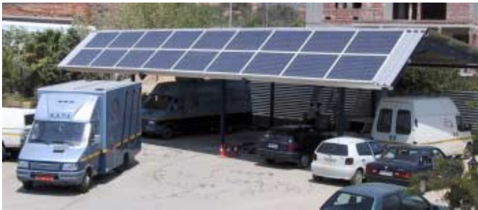
Σχήμα 6: Διασυνδεδεμένο Φ/Β σύστημα ενσωματωμένο στο σκίαστρο του χώρου στάθμευσης των εγκαταστάσεων του ΚΑΠΕ.
