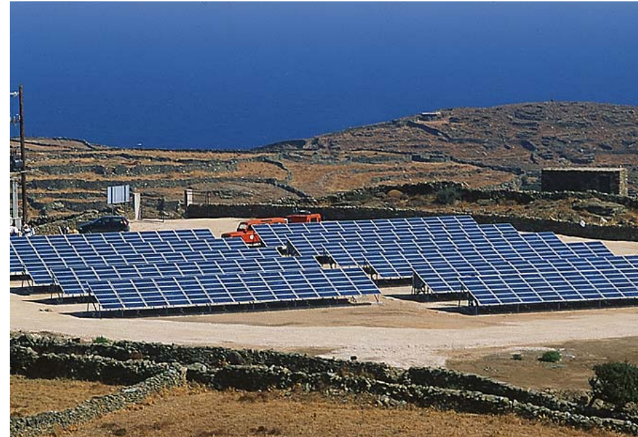
Φ/Β σύστημα 60kWp στη Σίφνο (1999) 16
