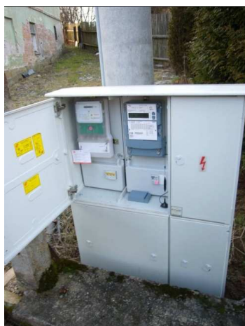
Übergabestelle PV zum Netz
