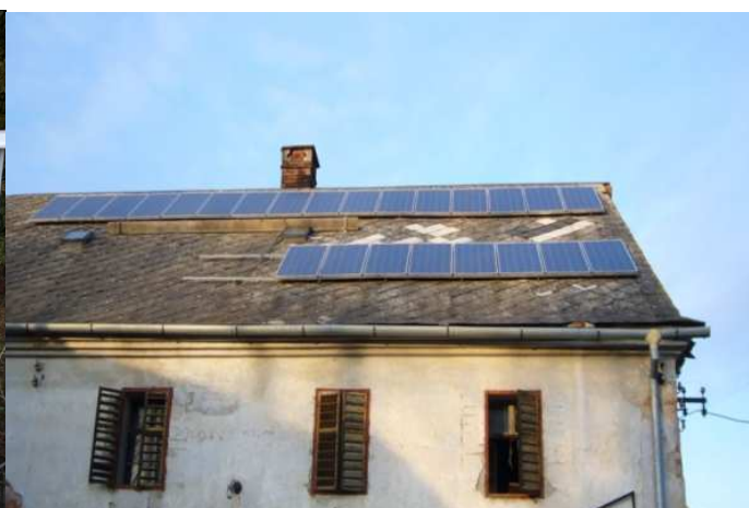
Standort der PV Paneele
