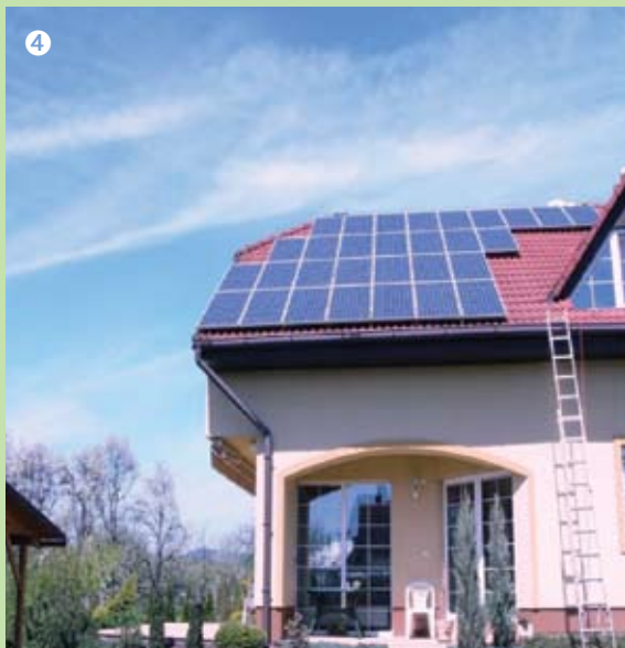
Sistema FV montado em edifício de Březová, República Checa, com capacidade instalada de 4,35 kWp
