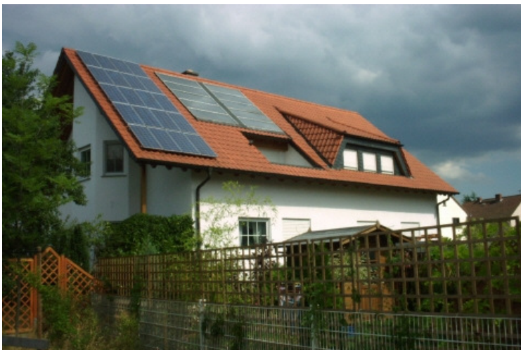
Fotovoltaické články na střeše rodinného domu
