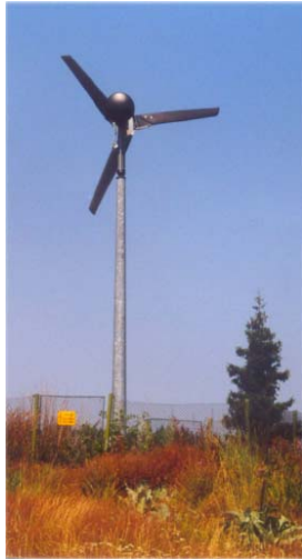
Sistema de pequena turbina eólica
