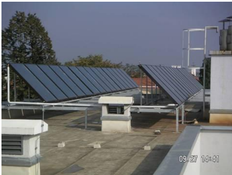
Slika 13 Ravni pločasti kolektor na krovu staračkog doma “Kuća Sv. Franje”, Odra, Zagreb
