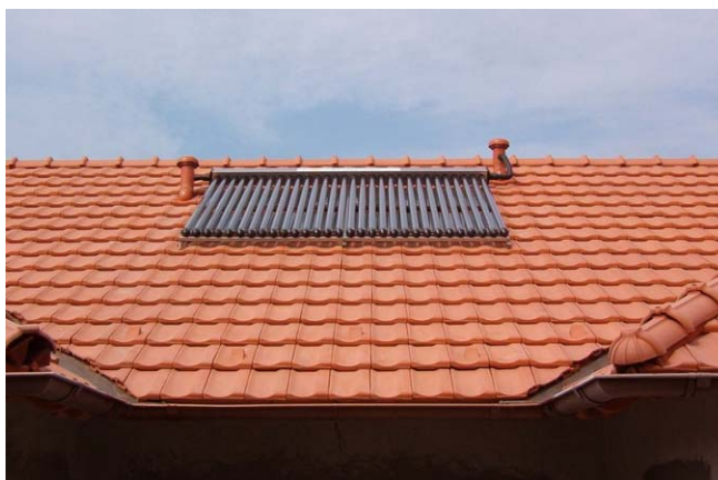
Figure 21: Szolár termál kollektor egy családi házon (Forrás: Kardos Labor Kft)
