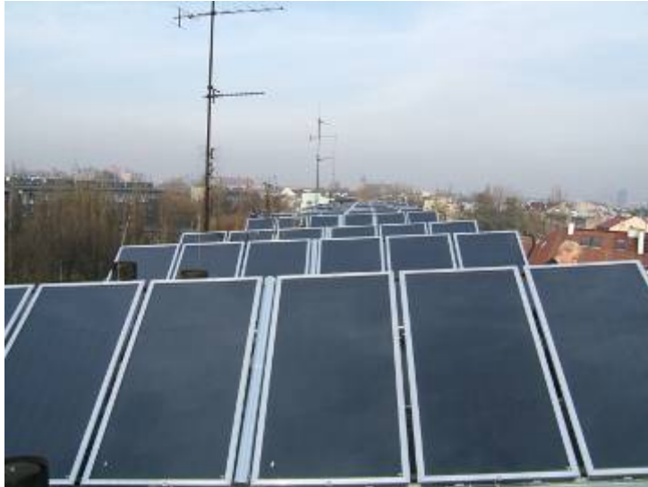
Rys. 27: Widok ogólny na system kolektorów słonecznych dla budynku mieszkalnego.
