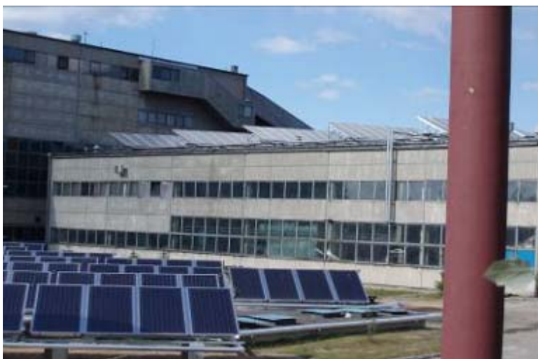
Rys. 31: Widok ogólny na system kolektorów słonecznych na budynku zakładu ciepłowniczego w Wołominie.
