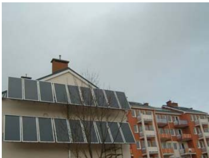
Rys. 28: Widok ogólny na system kolektorów słonecznych dla budynku wielorodzinnego.
